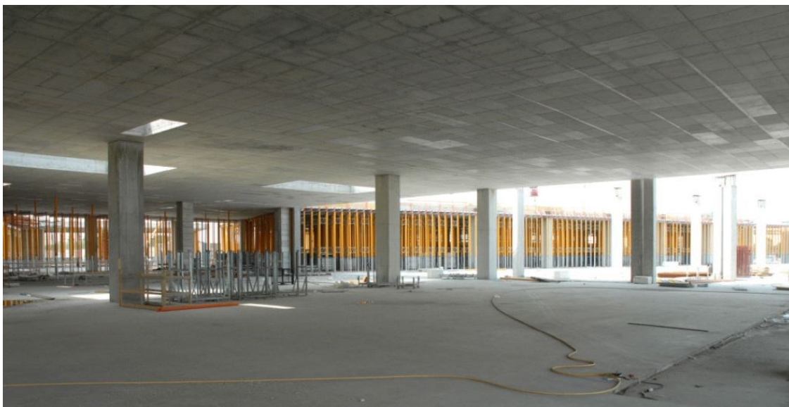
Figura 62: Centro commerciale Auchan a Cinisello Balsamo; vista interna della maglia dei pilastri dopo il disarmo dell'impalcato.
