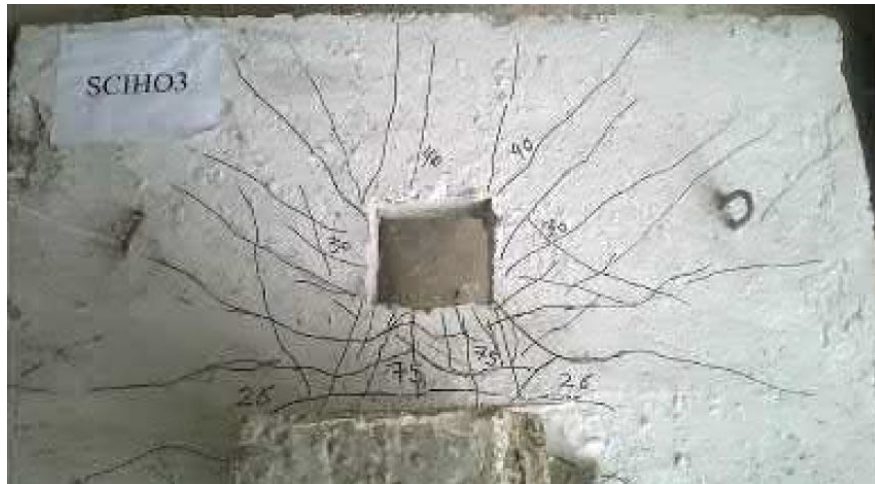
Figura 44: Quadro fessurativo post rottura per taglio/punzonamento nel caso di apertura in prossimità del pilastro; vista piastra dal basso.
