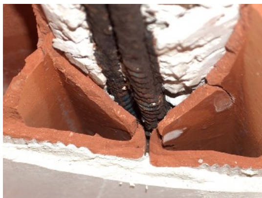
Figura 35: Mancato avvolgimento delle barre d'armatura dei travetti.
