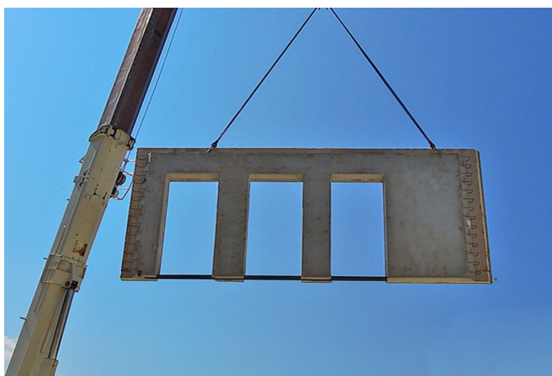
Figura 14: Prefabbricazione pesante a grandi pannelli: sollevamento in cantiere di un pannello-parete prefabbricato.
