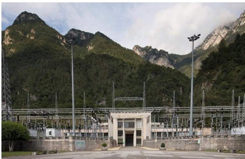
Figura 2. Centrale idroelettrica "Achille Gaggia" di Soverzene. Piazzale antistante l'ingresso alla centrale (in caverna)
