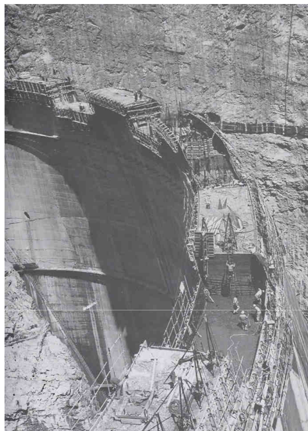
Particolare costruttivo dei conci dell'arco verticale nella parte superiore della diga a doppio arco
