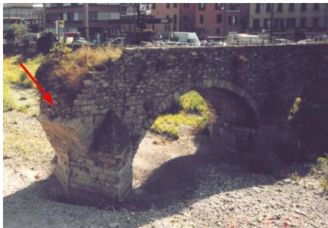
Figura 1.6 Ponte di S. Agata – Genova: stato di fatto a seguito delle alluvioni del 1970 e 2011 che hanno determinato il collasso di parte delle arcate che lo formavano. La freccia rossa indica la parte dell'arcata conservata, come se le reni fossero rialzate di un angolo prossimo a 30^\circ . [8]
