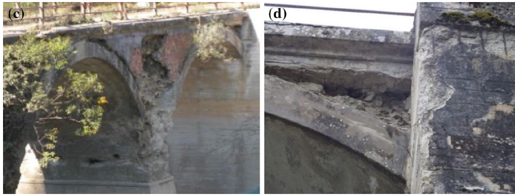
Figura 3.44 Danneggiamenti del ponte ‘Cinque Occhi’: (a) prospetto longitudinale del ponte e sue condizioni globali; (b) particolare del collasso dei timpani; (c) particolare del collasso dei timpani e della perdita di materiale in corrispondenza delle imposte; (d) collasso di un timpano in corrispondenza della spalla sud e danneggiamento preesistente della struttura in calcestruzzo armato. [87]
