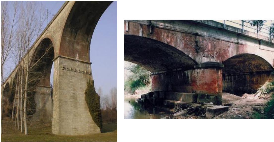
Figura 1.5 Viadotto Pesio – linea Fossano-Ceva, progressiva 14+200 (a); Ponte Meletta – linea Trofarello-Cuneo, progressiva 19+256 (b). [8]
