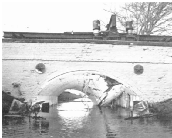
Figura 3.10 Torksey Bridge : prospetto nord (in alto a sinistra), condizioni della spalla a sud ovest (in alto a destra) e condizioni al momento del collasso (in basso al centro). [48]
