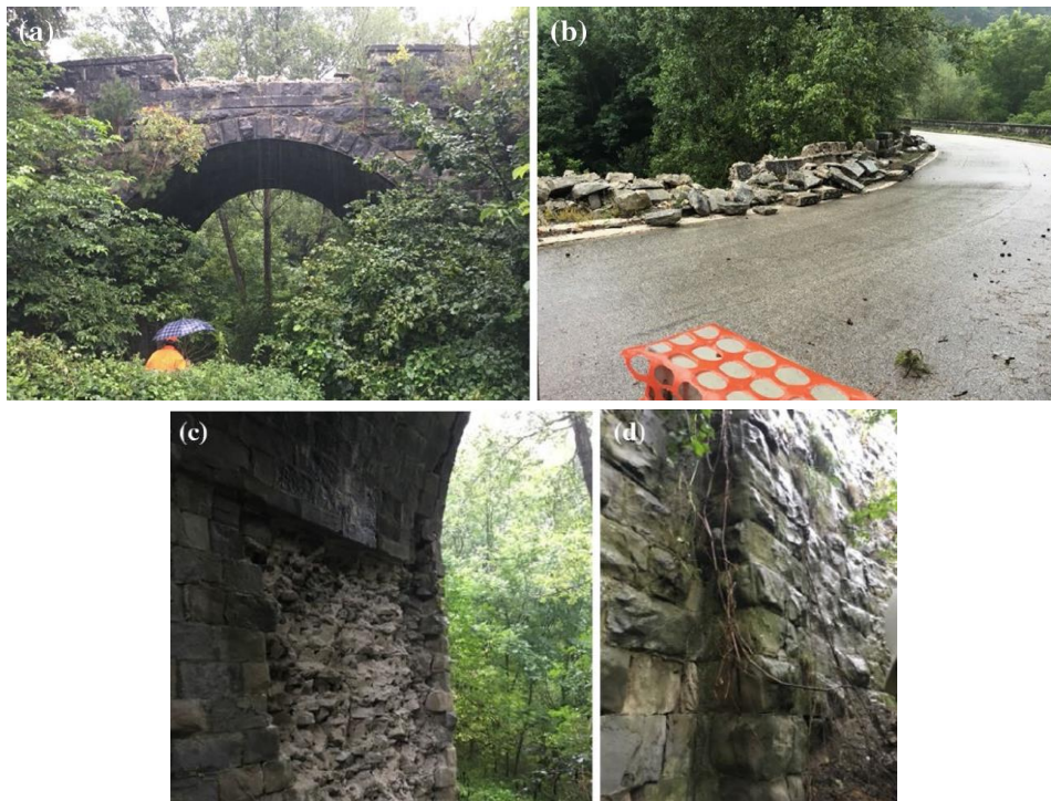
Figura 3.46 Danneggiamenti del ponte a tre campate lungo la strada ‘Trisungo-Tufo’: (a, b) collasso fuori piano del parapetto relativo alla campata centrale; (c, d) espulsioni e fessurazioni di alcuni elementi murari. [87]
