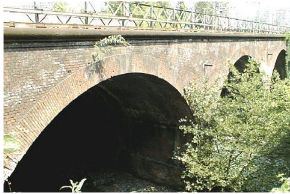
Figura 1.36 Timpano dotato di coronamento in pietra a taglio (ponte Dora – linea ferroviaria Torino-Milano, progressiva 5+915). [8]
