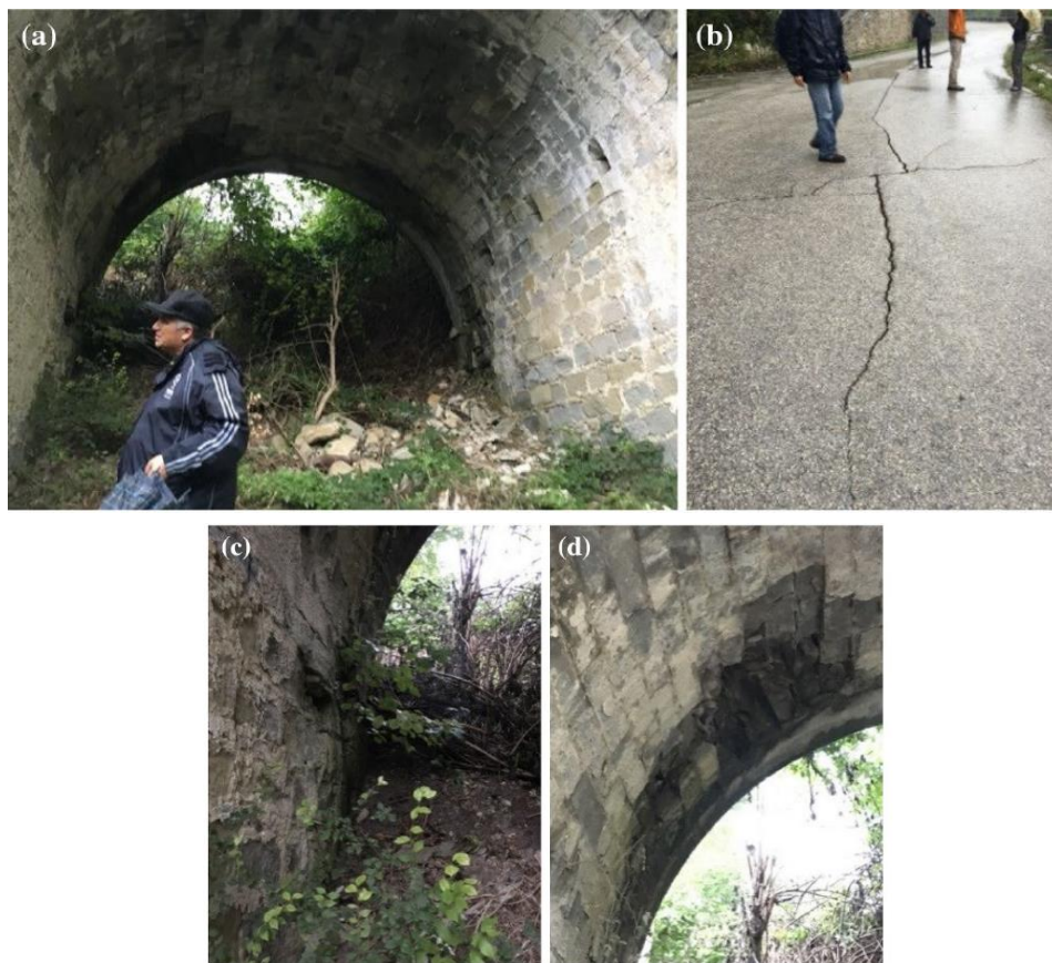
Figura 3.45 Danneggiamenti del ponte mono-campata lungo la strada ‘Trisungo-Tufo’: (a) vista dell’arcata; (b) danneggiamento della pavimentazione stradale; (c) espulsione del paramento esterno di una spalla; (d) espulsione di parte dell’intradosso dell’arcata. [87]
