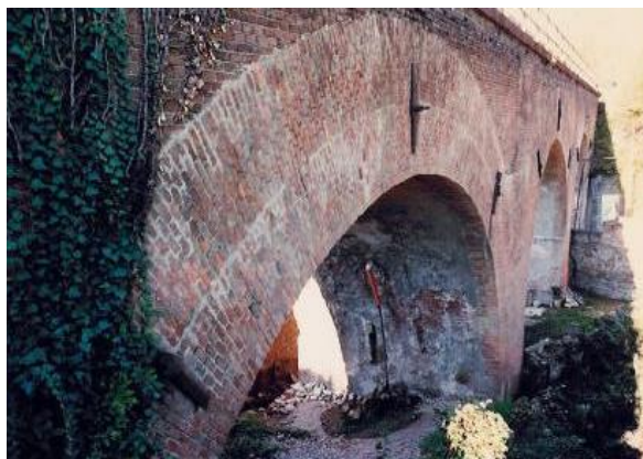
Figura 1.13 Arcata a due strati realizzata con il metodo delle zone concentriche presente in un ponte ferroviario della linea Savona-Carmagnola, progressiva chilometrica 44+477. [8]
