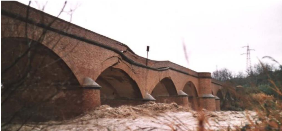
Figura 3.27 Collasso del ponte Trigno durante l'alluvione del Basso Molise risalente al 25 Gennaio 2003. [65]
