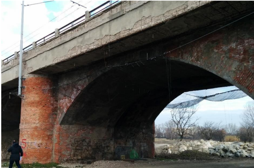
Figura 5.17 Vista da monte (sud) dell'arcata numero 5 in cui si nota lo spessore dell'arcata ed il danneggiamento del manufatto in cemento armato. [25]
