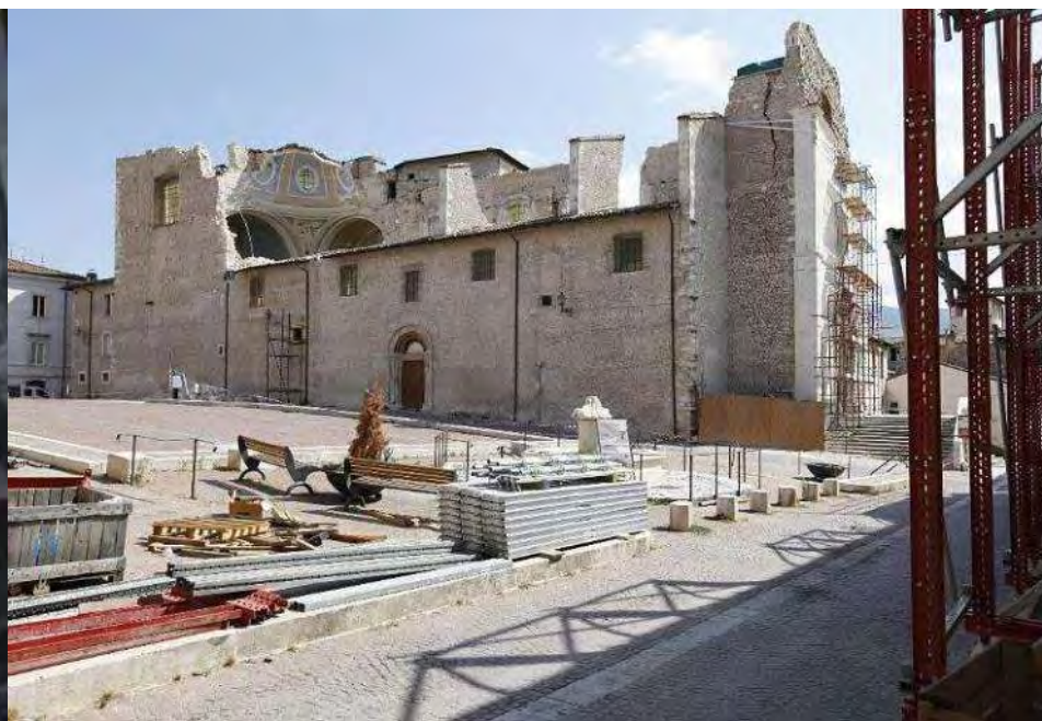
Situazione post sisma 2009
