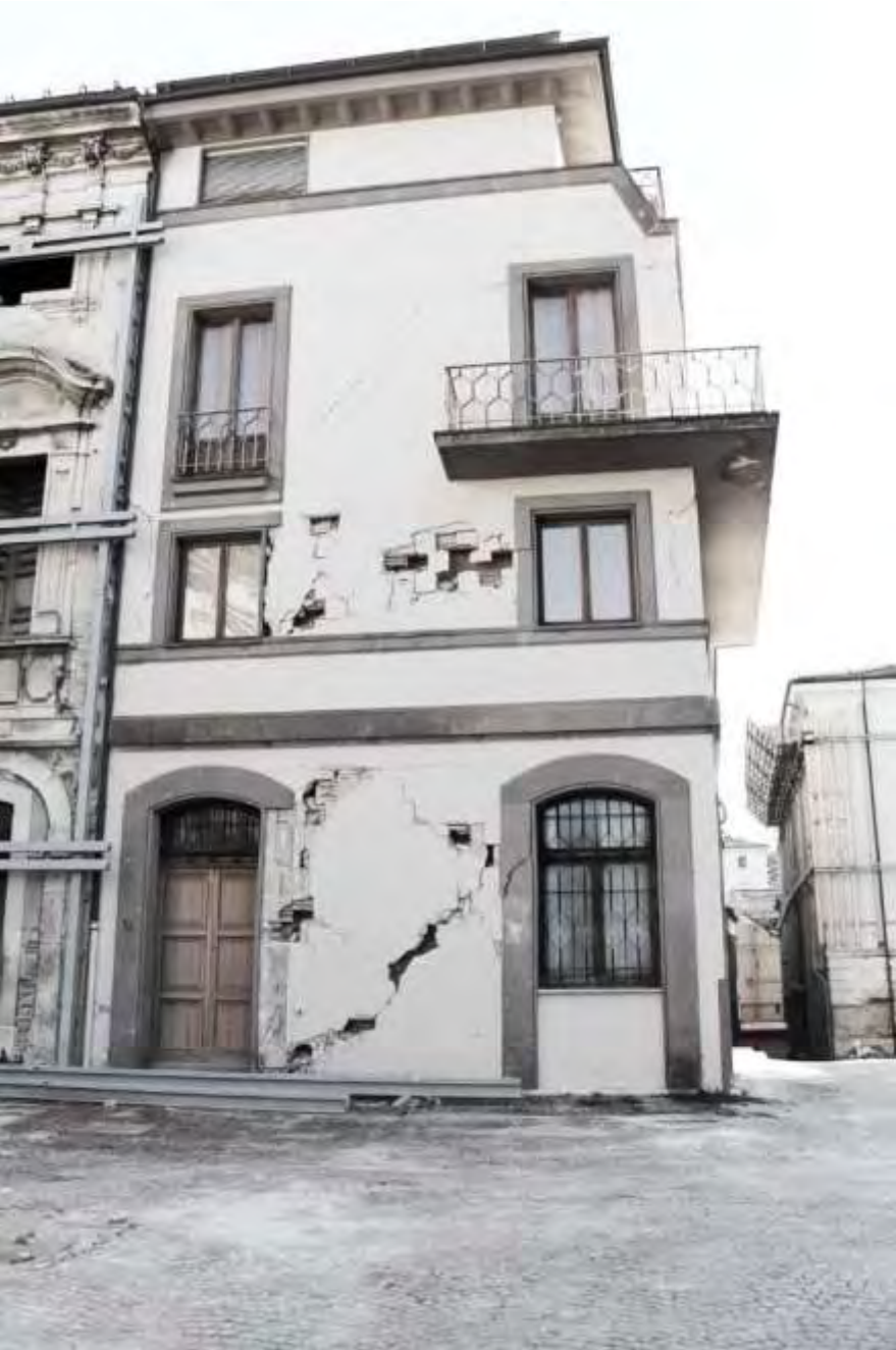
Situazione post sisma 2009
