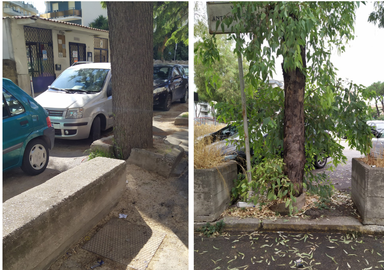
Figura 7 – Particolare fotografico dell'innalzamento del manto stradale dovuto all'ingrossamento delle radici in Via de Chirico (a sinistra) e nel parcheggio tra Piazza Bernini e Viale degli Artisti.
