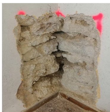
Fig. 4.1.12 Scarso ammorsamento tra pareti ortogonali.
