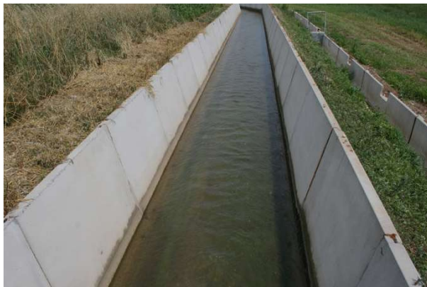
CANALE IRRIGUO IMPERMEABILE
